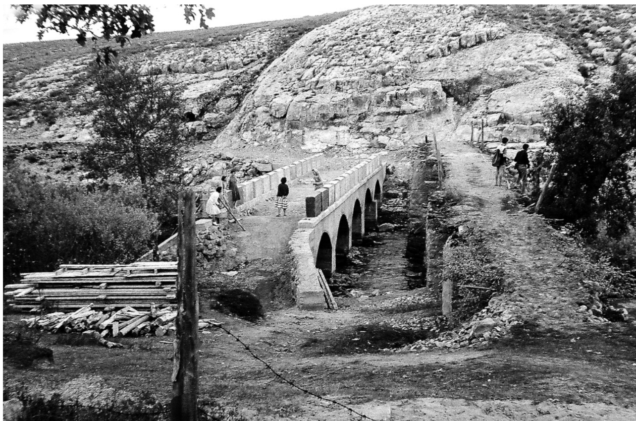
Puente moderno de Dombellas en fase final de construcción al lado del antiguo
