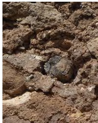
Restos de madera hallada en los muros.
