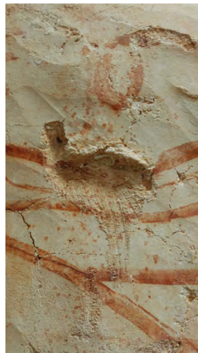
Ilustr. 20. Llaga del Cristo del Calvario, excavada sobre el enlucido
