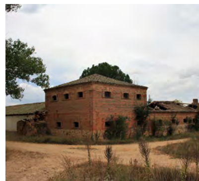
Antiguo lavadero, su estado amenaza ruina total.
