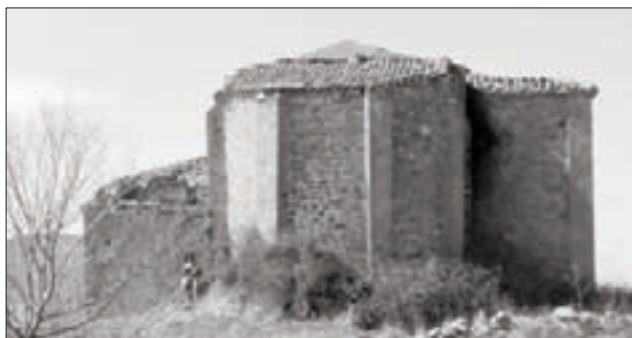
Fotografía donde se aprecia la cubierta del presbiterio y el derrumbe de la parte de la sacristía.
