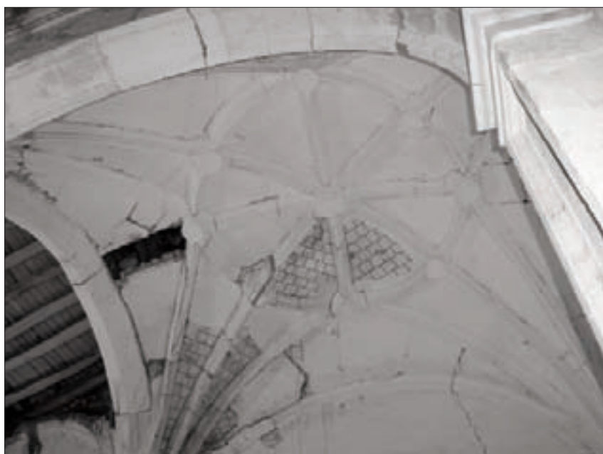
Bóveda central de la Iglesia de Masegoso donde se aprecia la falta de un trozo de plementería.
